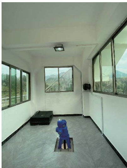
铸铁闸门螺旋杆启闭机采用风光互补供电系统的电池组和螺旋杆启闭机
