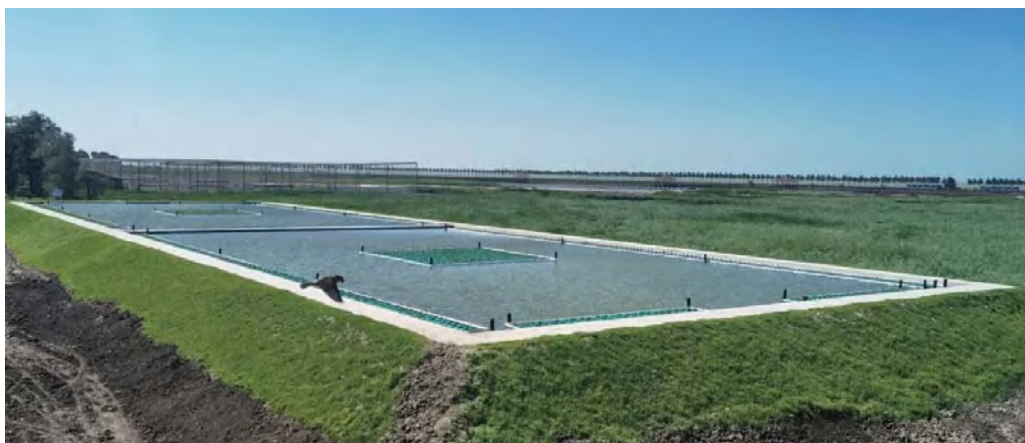
建成后的沉淀池及稳定池
