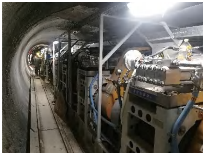
高压泵组运行
