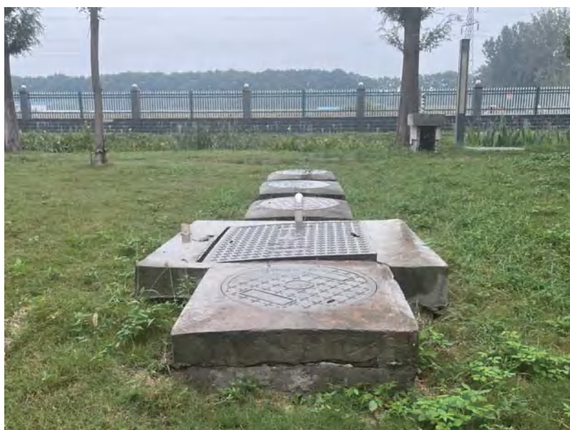
建成的一体化设备
