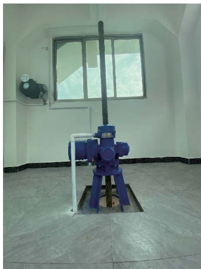
铸铁闸门螺旋杆启闭机采用风光互补供电系统的控制系统和螺旋杆启闭机
